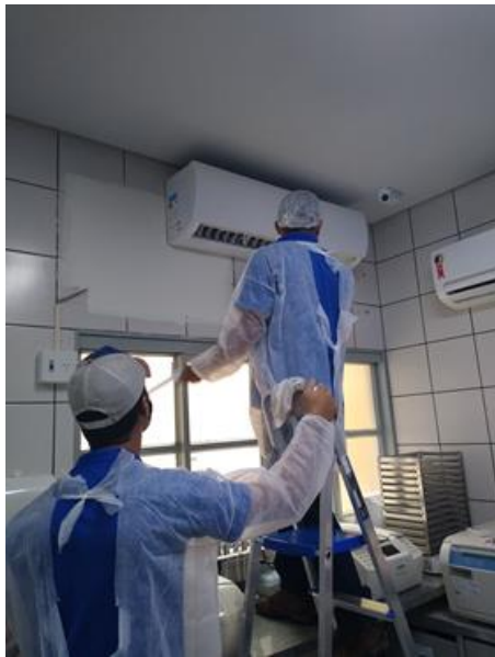
Figura 1. Preventiva dos ares-condicionados
