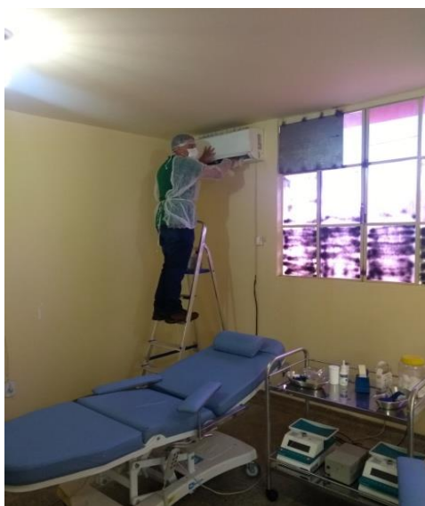
Manutenção do ar-condicionado.
